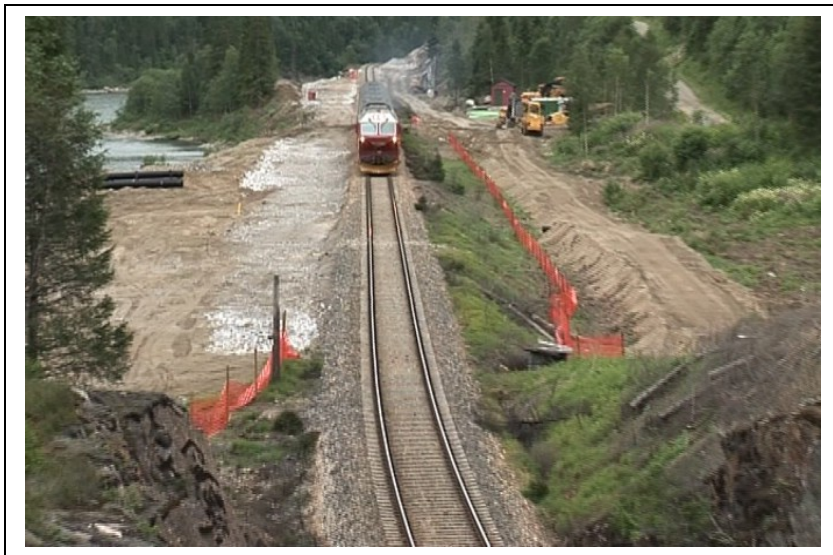
Jernbaneverket bygger nå et 1000 m langt vekslingsspor ved Eiterstraum/Eiteråga 17 km sør for Mosjøen. Dette og fjernstyringen styrker kapasiteten for godstrafikk på Nordlandsbanen. Foto: E. Kantun 20©05.
