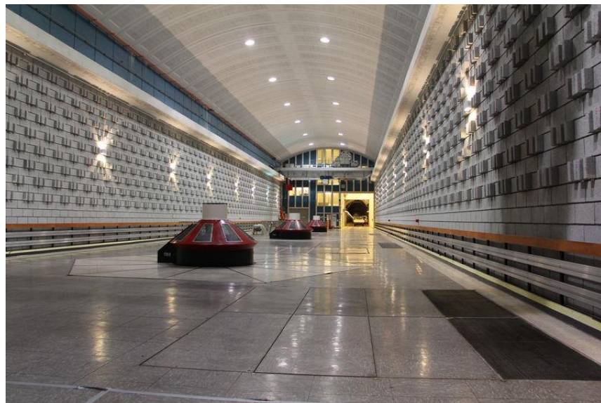
Maskinhall Skjomen kraftverk
