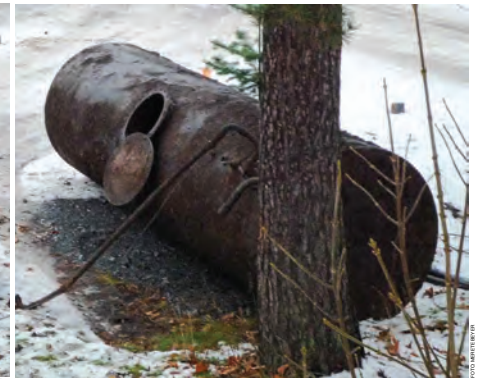
Klima- og forureningsdirektoratet har tidligere anslått at det finnes 300 000 nedgravde oljetanker i Norge. Lekkasje fra slike tanker er en av de største kildene til grunnforurensning.
