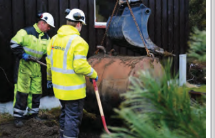
GRAVES OPP: Asker kommune og Naturvernforbundet oppfordrer deg til å skifte ut den gamle oljetanken med nyere oppvarmingsalternativ. Anslagsvis 3.000 oljetanker ligger nedgravd i Asker. (FOTO: NATURVERNFORBUNDET)
