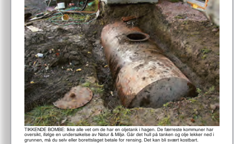
TEKKENDE BOMBE: Ikke alle vet om de har en oljetank i hagen. De færreste kommuner har oversikt, følge en undersøkelse av Natur & Miljø. Går det hull på tanken og olje lekker ned i grunnen, må du selv eller borettslaget betale for rengjøring. Det kan bli svært kostbart. FOTO: OSLO KOMMUNE
