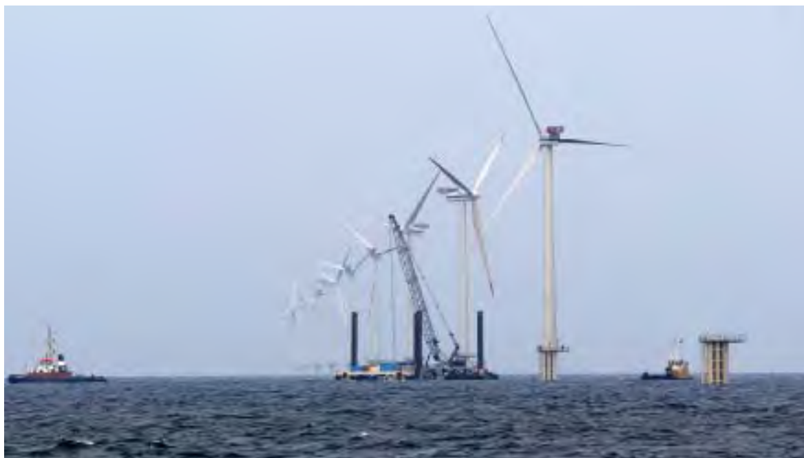
Havsul-utbyggingen i Møre og Romsdal kan bli verdens største vindmøllesatsing til sjøs. Her fra byggingen av vindmølleparken ved Horns Rev i Danmark. (Foto: Elsam A/S)
