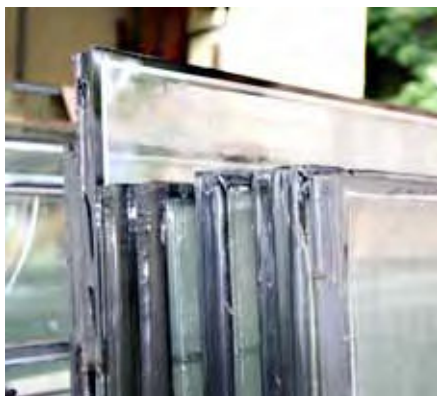
Det er i limet og tetningsmassen rundt glasset at man finner PCB eller klorparafiner.
