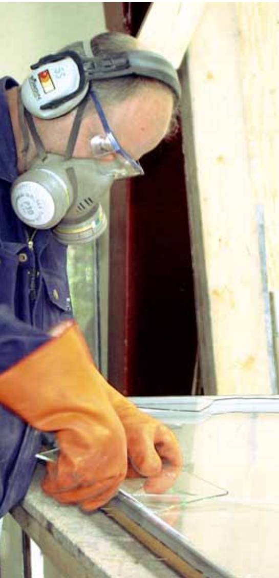
Et PCB-holdig vindu behandles hos PCB-Sanering i 2006. Nå ønsker de å utvide ordningen til også å gjelde vinduer med klorparafiner.
