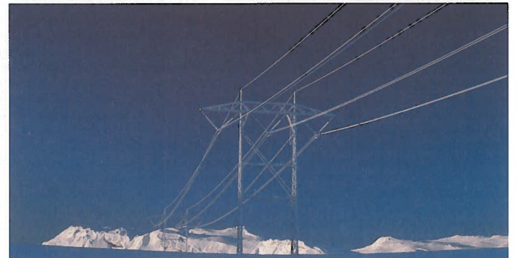
De nye stasjonsanleggene og ledningene vil nesten utelukkende bygges over bakken. Det er i liten grad lagt opp til underjordisk kabelbygging. (Foto: Helge Sunde/ Samfoto)
