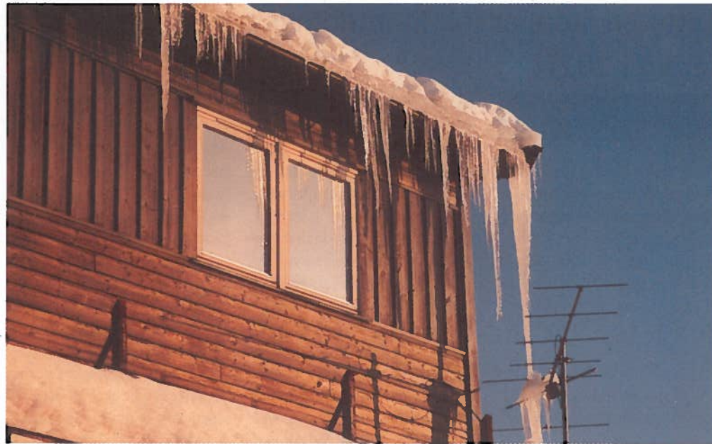
Ser takskjegget dit slik ut bør du ta deg en time på loftet. (Foto Jens P. Toldnæs)
