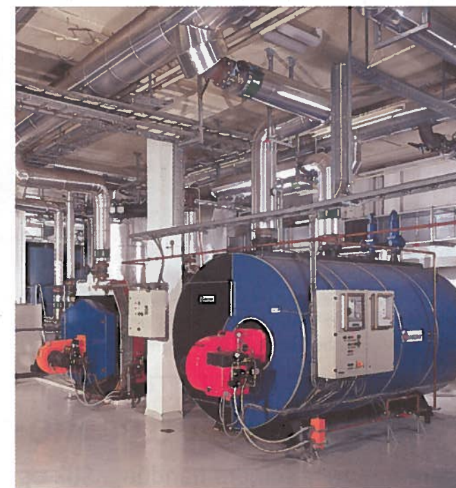
Landets største videregående skole, Sogn i Oslo, har erstattet oljefyring med bioenergi. Dermed har de kuttet CO 2 -utslippene med 2500 tonn. (Foto: Bioenergi AS)
