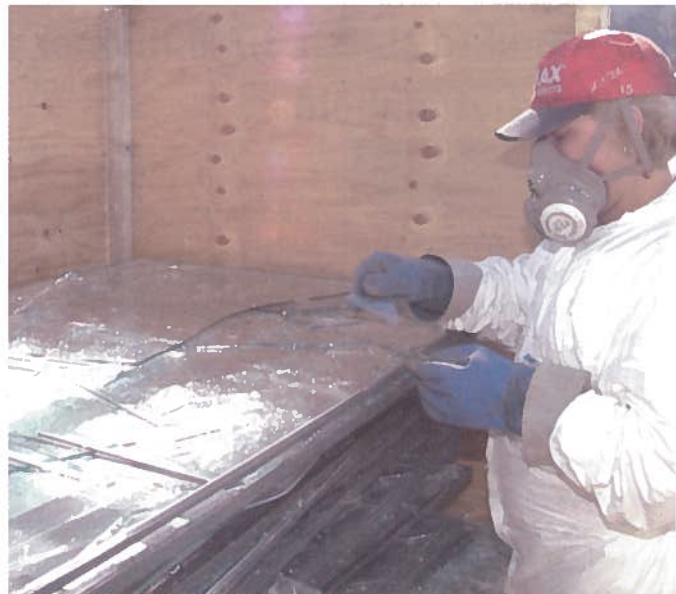
(Foto: PCB Sanering AS)
