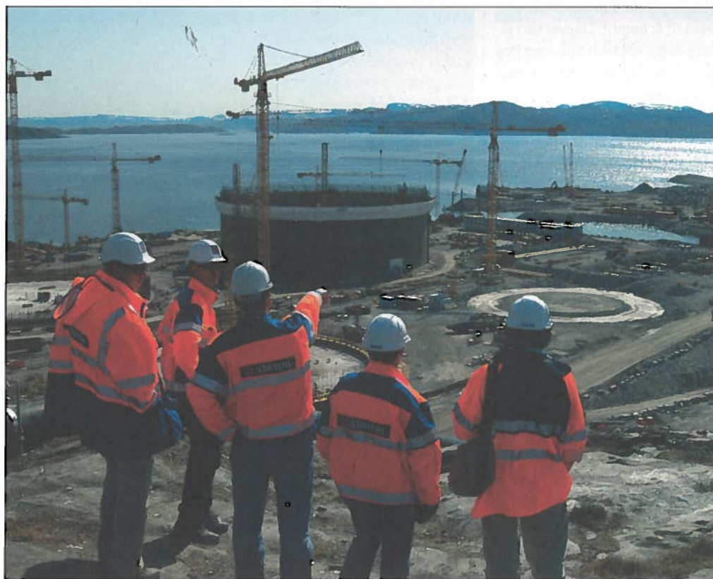
Gasskraftverket på Melkøya utenfor Hammerfest skal stå ferdig i 2006. (Foto: Statoil)
