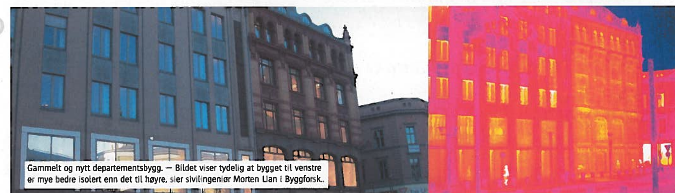
Pablo Picassos kunstverk skjuler en kraftig energilekkasje. Etasjeskillene er som en kuldebro som slipper ut varme.
