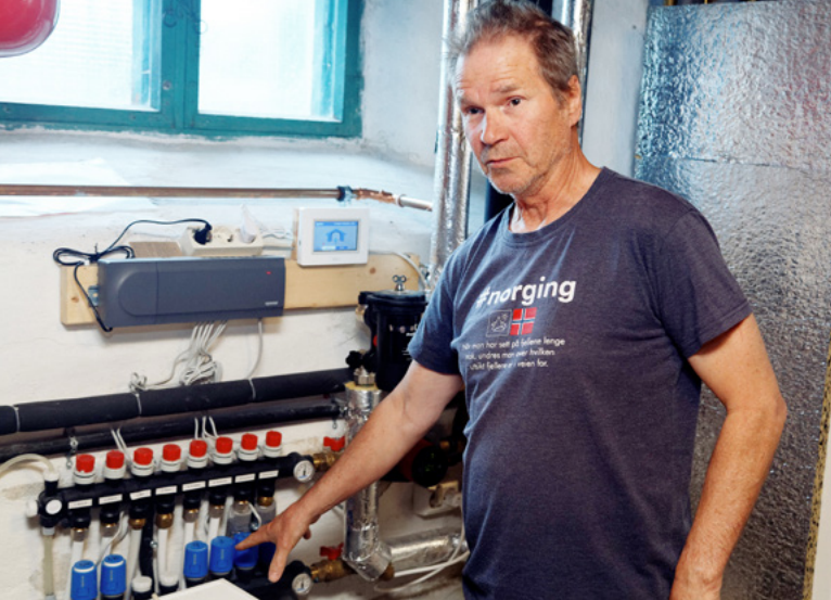
Stein viser fram rørsystemet som regulerer strømmen av varmtvann i huset.
