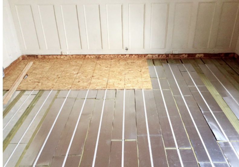
Varmtvannsrørene er lagt på aluminiumsprofiler under tregulvet i stuen. Dette hjelper å stpre varmen jevnt utover. Foto: Privat.
