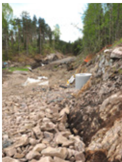
Arealinngrep er den største trusselen mot naturmangfoldet. Vi tar stadig større biter av naturen. Her fra skianlegget ved Linderudkollen. Foto: Gjermund Andersen.
