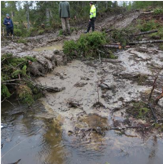
Ved 3 av 4 midlertidige bruer er det massiv tilførsel sedimenter til elva. (Foto:Statsforvalteren i Trøndelag)
