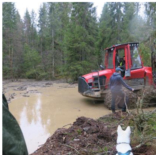
Ved brua i Eksetelva er det også massiv erosjon, og et «sedimentbasseng» inntil elva. (Foto:Statsforvalteren i Trøndelag)
