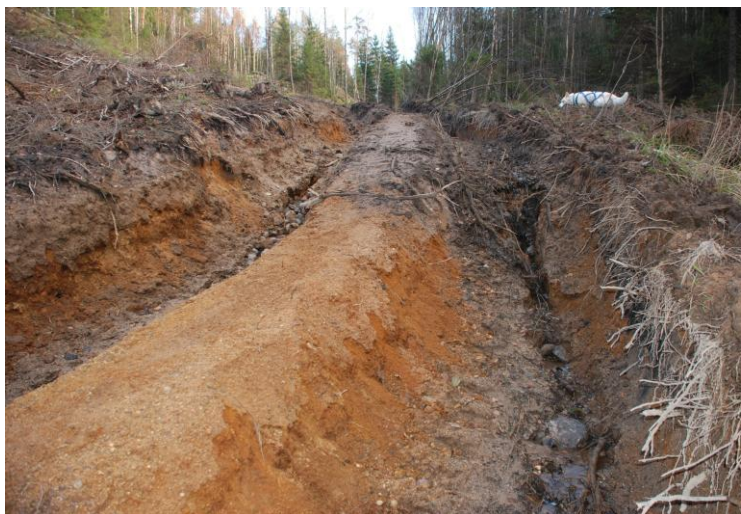
Bilde11: Mangelfull utbedring av kjørespor kan føre til alvorlig erosjon. (Foto: Ola Martin Wergeland Krog)
