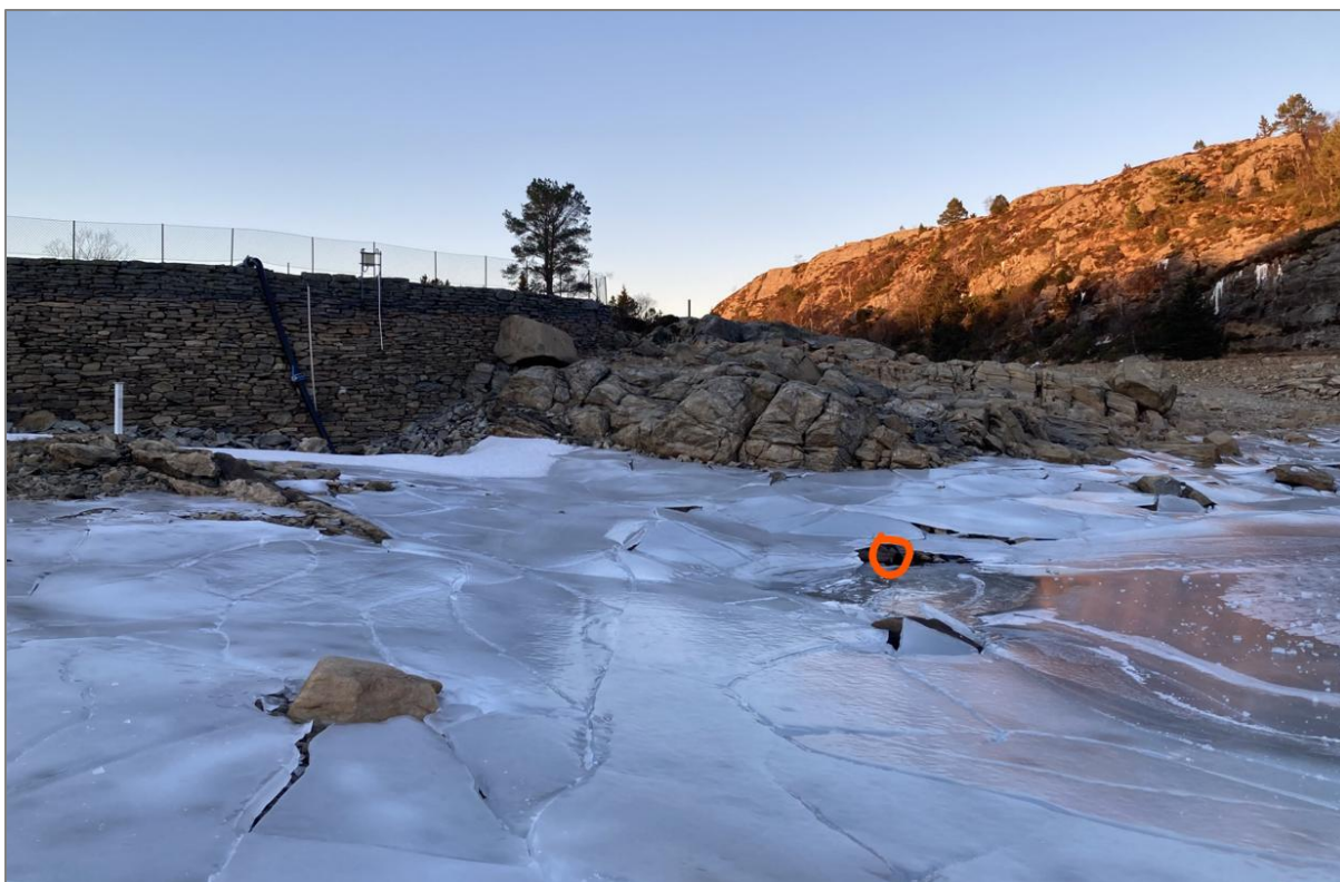
Figur 5. Dette bildet fra januar 2026 viser omtrent naturlig vann-nivå (øverste del av is). Den øverste del av isen skyldes at tapperøret var ute av drift i desember 2025, og det tok noen uker å tappe vannet ned igjen. Rørinntaket (og vannstanden i januar 2026) er markert med oransje. Foto: Gunvar Mikkelsen / FNF Hordaland.
