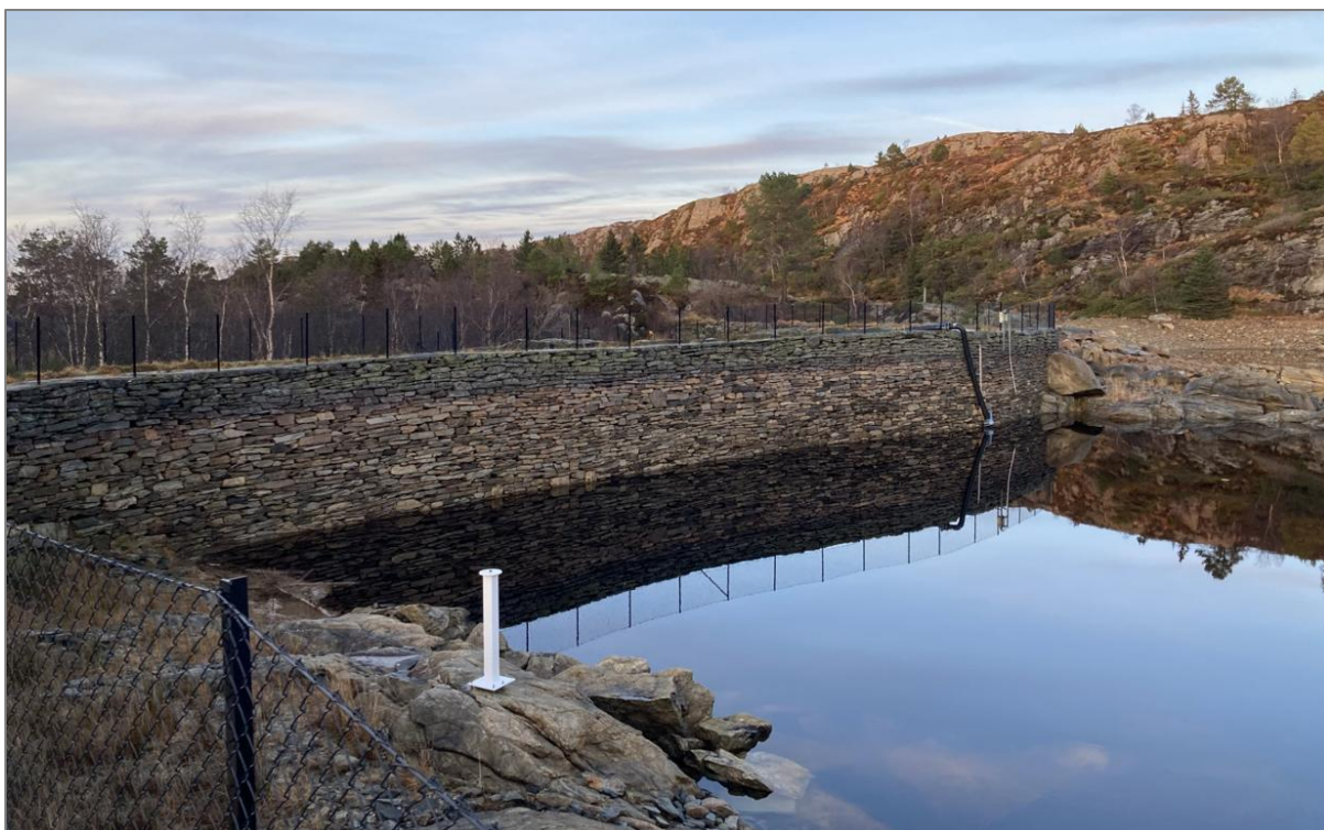
Bilde fra 23. desember 2025. Vannstanden var da omtrent 3 meter høyere enn nedtappet nivå, og det tok flere uker å tappe vannet helt ned igjen. Det var ingen tegn til lekkasje gjennom demningen, selv om den nå har stått tørr lenge.
