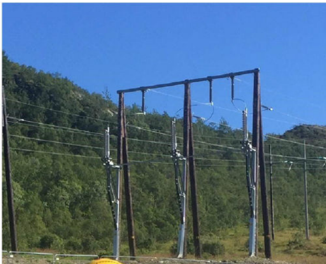
Figur 41: Eksempel på en 132 kV kabelendemast.
