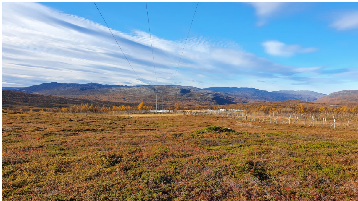
Figur 16: Foto av 66 kV traseen med gjerdeanlegg for rein like nordøst for Skaidi transformatorstasjon
